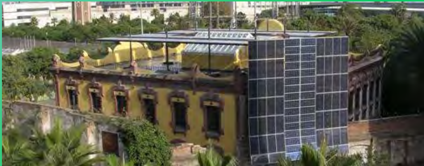
La Fabrica del Sol, Barcelona: 50 kW
