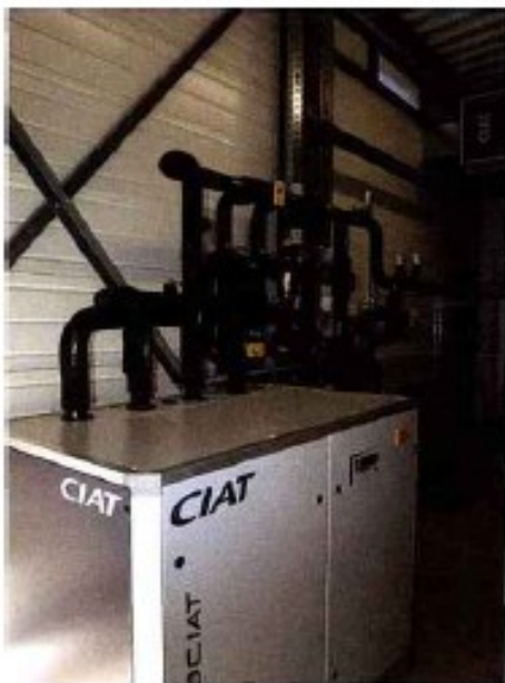
La pompe à chaleur mise au point spécifiquement pour ce site d'expérience travaille en geocooling au printemps.
